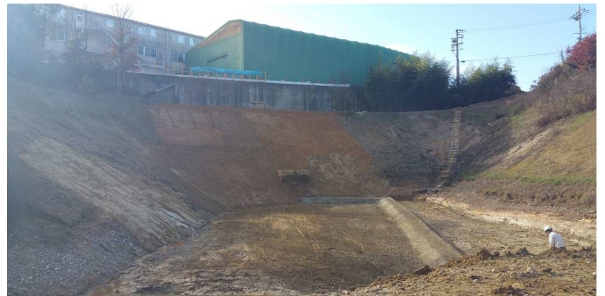
【2015.12.18 当日の法面復旧状況】
