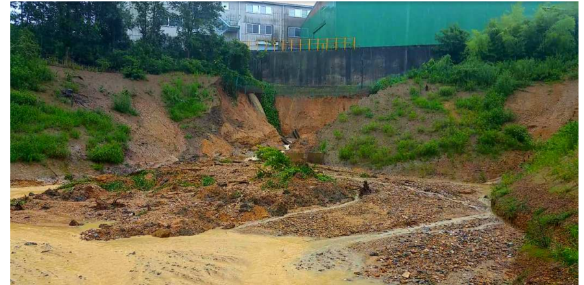
【2015.7.17 当日の法面崩壊状況】
